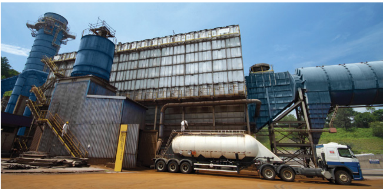
Gerdau recicla 100% do pó coletado pelos sistemas de despoeiramento das usinas em São Paulo e Rio de Janeiro
