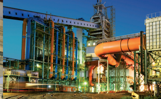
Alto-forno da Usina Gerdaul em Ouro Branco (MG)
